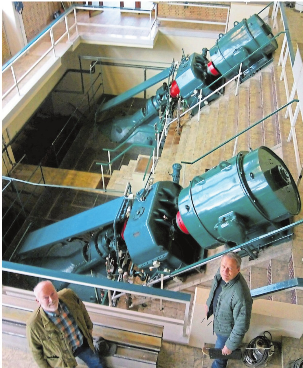
Reiner Haschen (links) und Jans Uwe Kock, Vorsteher beziehungsweise Geschäftsführer der Sielacht Bockhorn-Friedeburg, fragen sich, ob die riesigen Pumpen im Schöpfwerk dauerhaft ausreichen. Das Schöpfwerk verfügt über insgesamt vier Pumpen.
